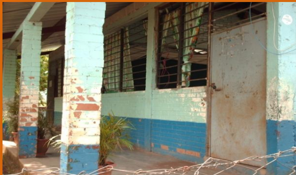
Estado físico de la escuela antes de iniciar la labor.
